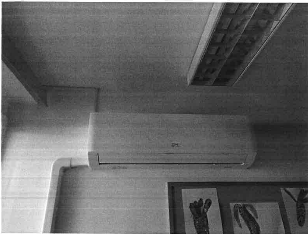
Privitak 2: Fotografija PŠ Lukač i instaliranog klimatizacijskog uređaja
